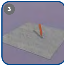
3 Skjær et første hull i mansjetten, bruk en bit av hylsen fra tettsjiktremsen som mal (diameter 80 mm), eller bruk JAFO skjæremal.
